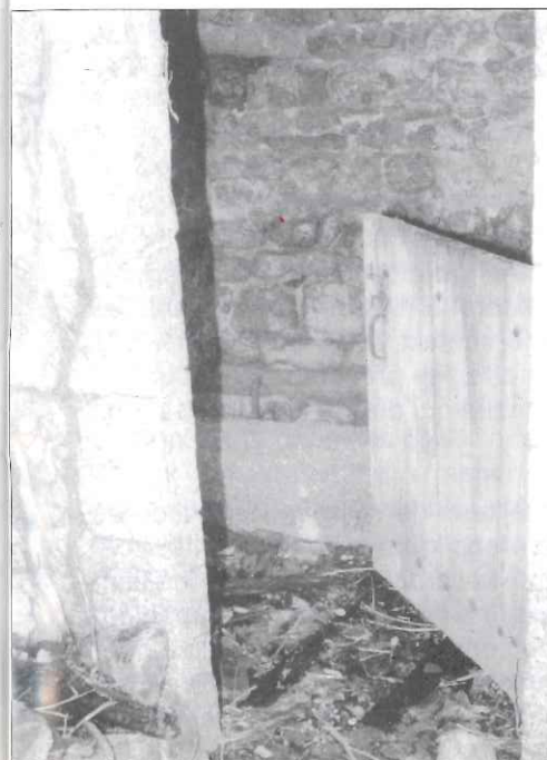
En bas, porte ouverte, on aperçoit les deux pierres de granit qui forment le siège des latrines.
