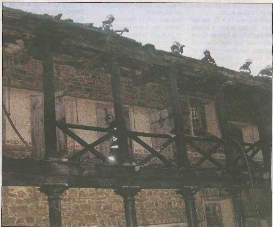
● Hier vers 18 h 20, le feu a pris dans l'ancienne prison de Guingamp. Les dégâts sont extrêmement importants. Il aura fallu 25 pompiers pour circonscire l'incendie. (Photo A.-M.Q)
