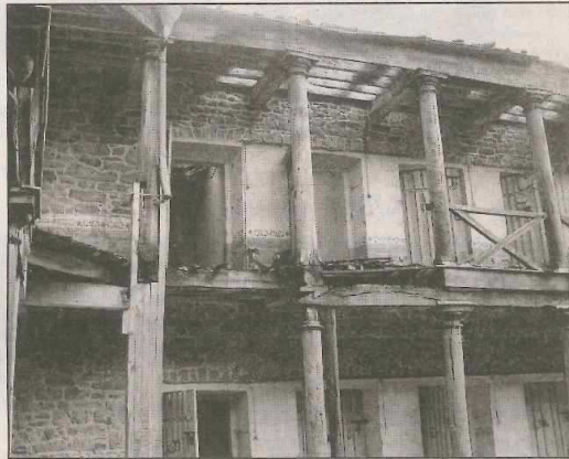
● Dans un état de détérioration avancé, certains planchers de la prison n'ont pas résisté aux flammes.
